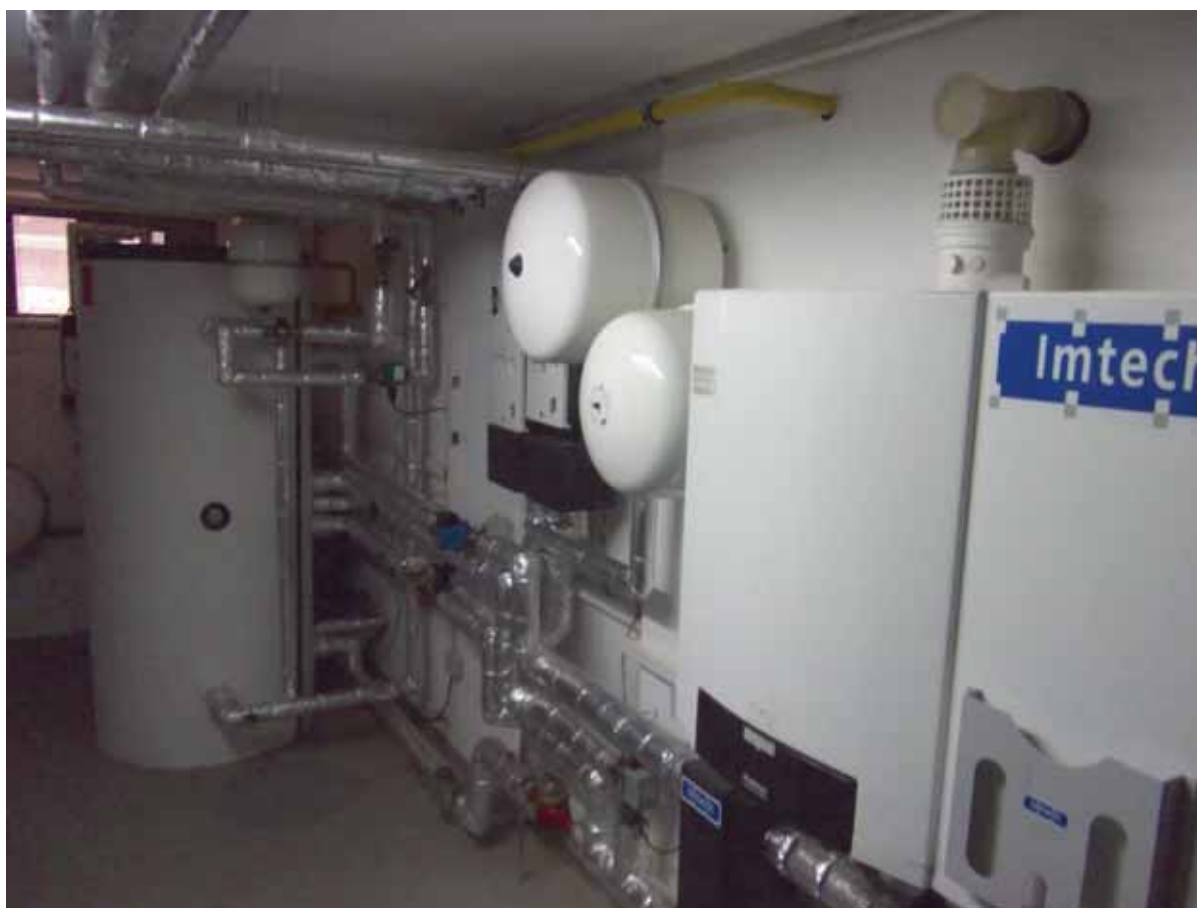
Foto rechts oben: Wärmedämmung an der Decke im Heizungskeller incl. Rauch- melder
